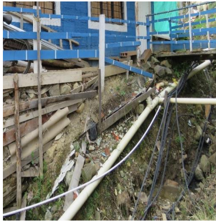
Fotografía 24. Tuberías de agua para el consumo y aguas negras. Fuente: Registro fotográfico personal. Tomada 29 de octubre de 2016
