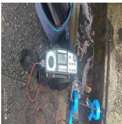
Fig. 23. Medición de resistencia de puesta a tierra.
