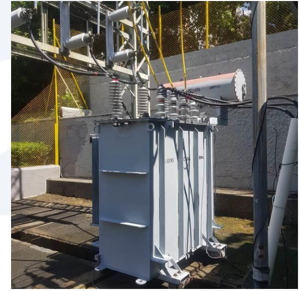
Fig. 37. Entrega de transformador.
