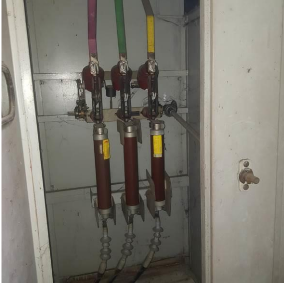
Fig. 46. Seccionador antes de mantenimiento.
