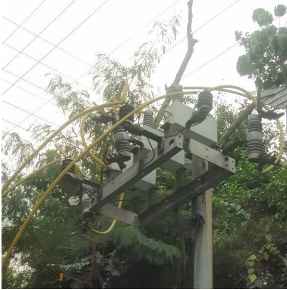
Fig. 50. DPS del transformador antes del mantenimiento.
