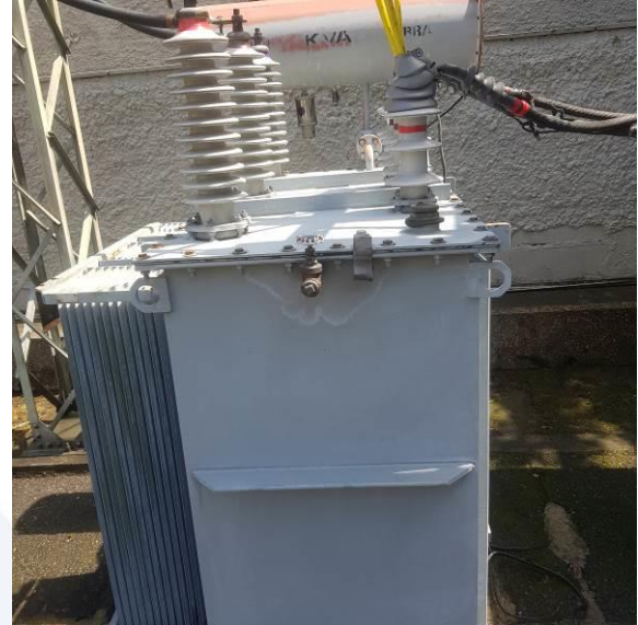
Fig. 39. Entrega de transformador.
