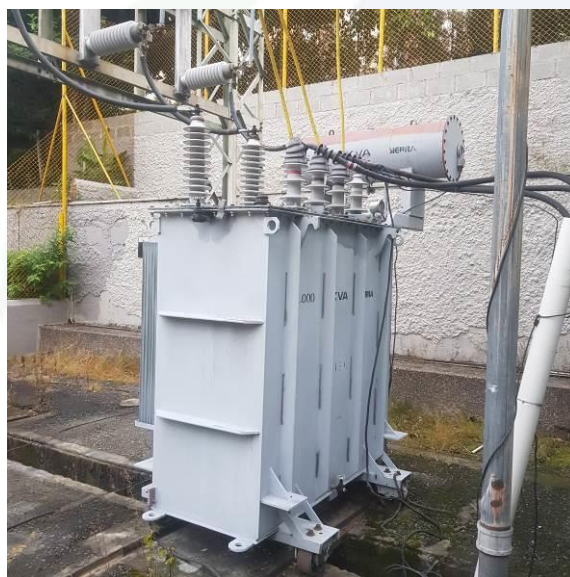
Fig. 3 Transformador antes de mantenimiento.
