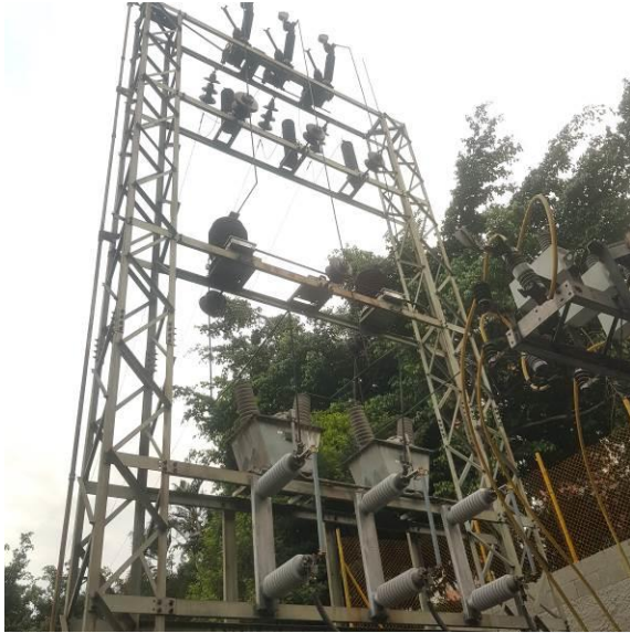
Fig. 34. Pórtico antes de mantenimiento.
