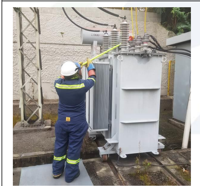
Fig. 8. Verificación de ausencia de tensión a transformador en subestación.
