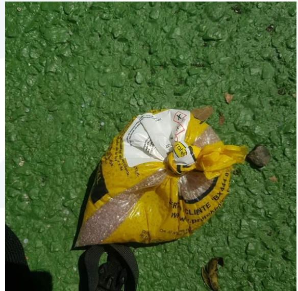
Fig. 21. Cambio de Silica de transformador.
