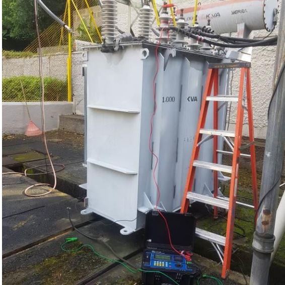
Fig. 14. Prueba de resistencia de aislamiento a transformador.
