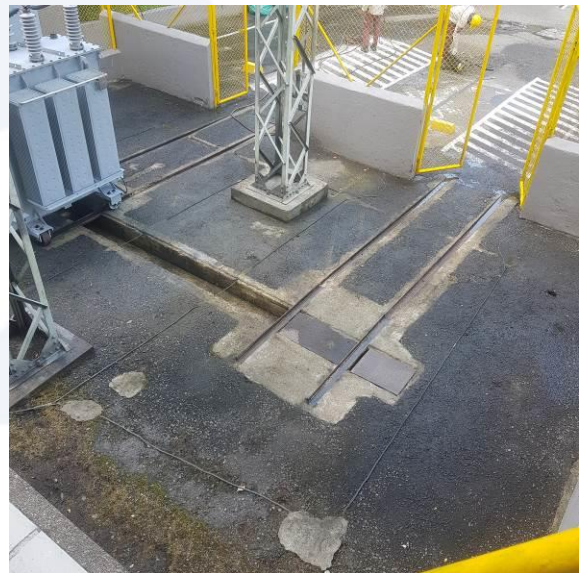
Fig. 53. Entrega de subestación.
