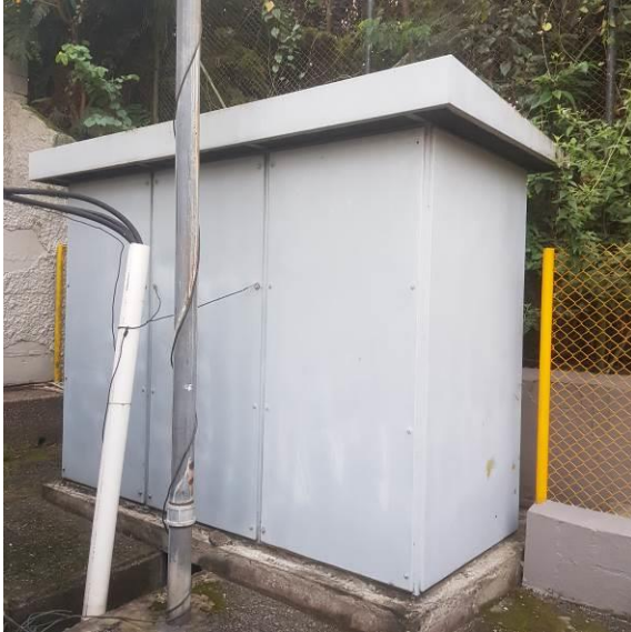
Fig. 42. Subestación antes de mantenimiento.
