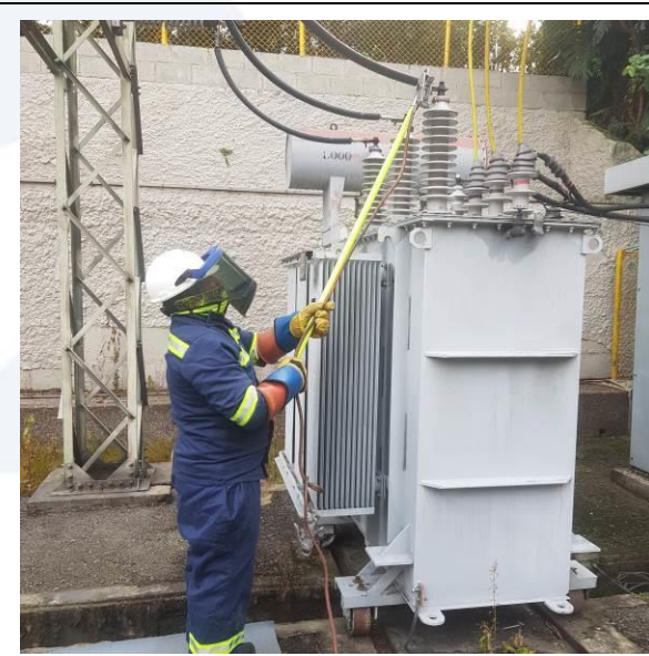
Fig. 9. Descarga de transformador a tierra.
