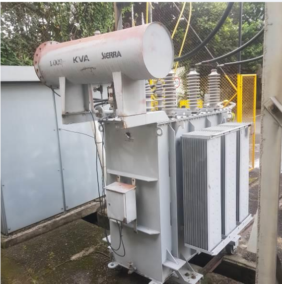
Fig. 40. Transformador antes de mantenimiento.
