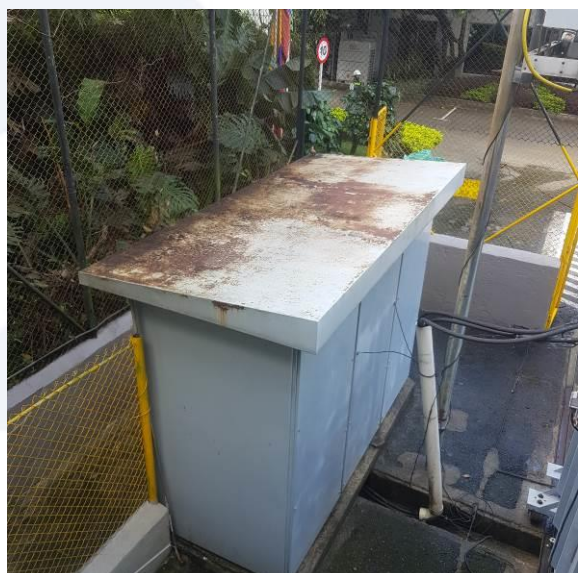
Fig. 45. Entrega de celda de seccionador.
