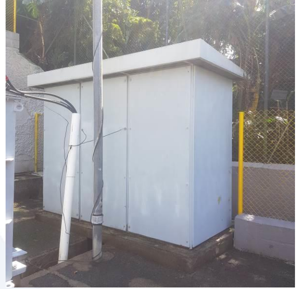
Fig. 43. Entrega de subestación.
