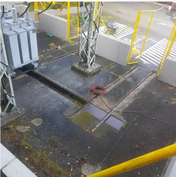
Fig. 52. Subestación antes de mantenimiento.
