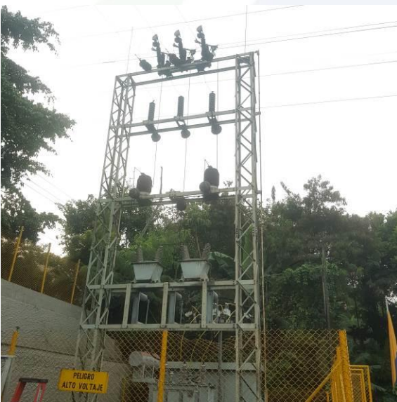
Fig. 32. Pórtico antes de mantenimiento.
