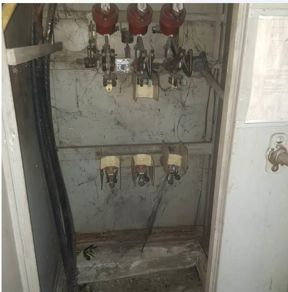
Fig. 48. Celda de seccionador sin uso antes de limpieza.
