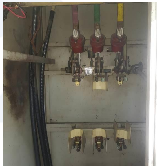
Fig. 49. Entrega de celda de seccionador.
