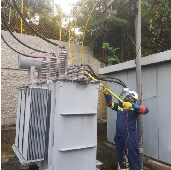
Fig. 10. Descarga de transformador a tierra.
