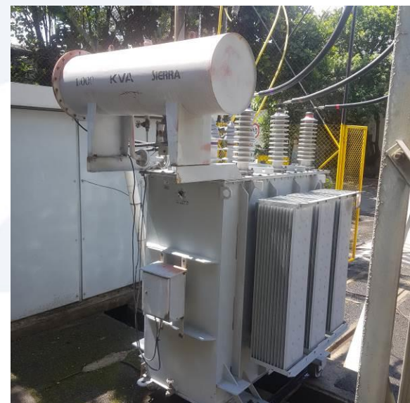
Fig. 41. Entrega de transformador.
