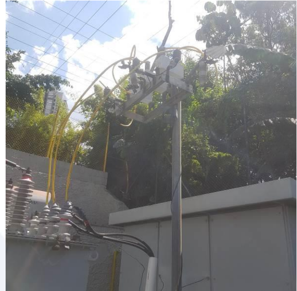
Fig. 51. Entrega de DPS del transformador.
