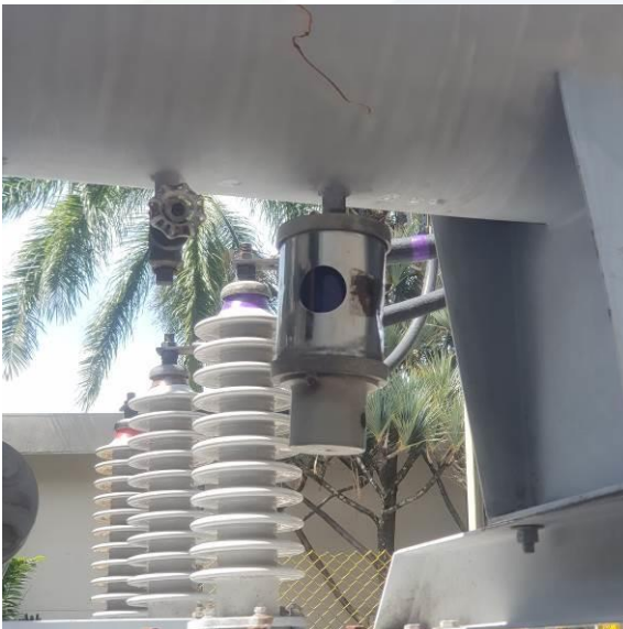
Fig. 20. Cambio de Silica de transformador.
