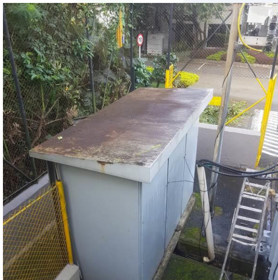
Fig. 44. Celda de seccionador antes de mantenimiento.
