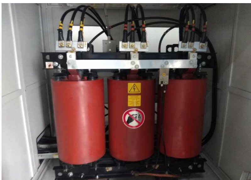
Figura 16. Transformador Subestación de servicios P1 [Fuente propia].
