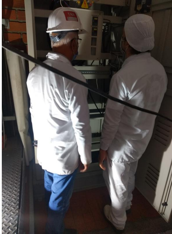
Figura 17. Toma de medidas de variables eléctricas con acompañamiento de personal calificado. [Fuente propia].
