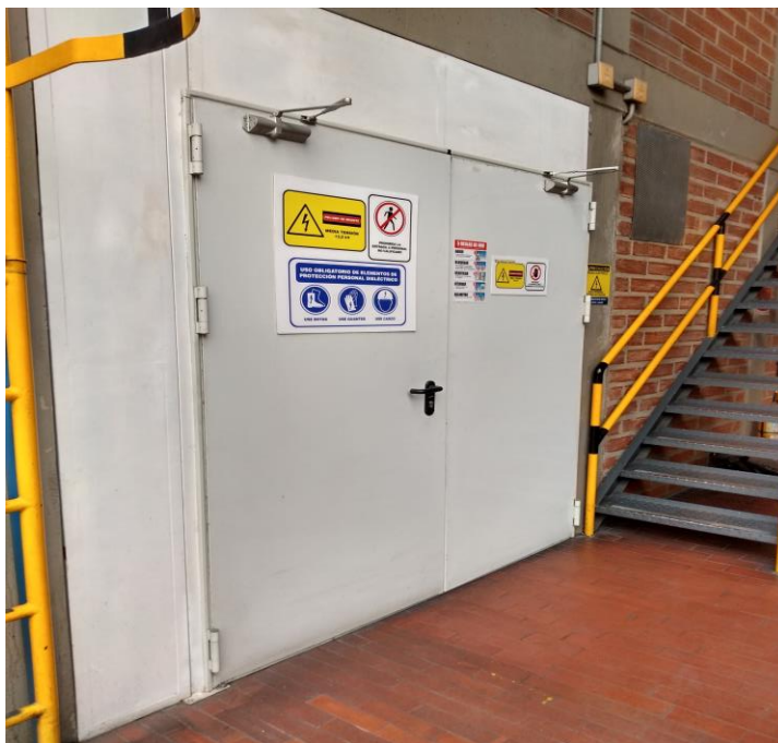
Figura 15. Subestaci3n de servicios P1
