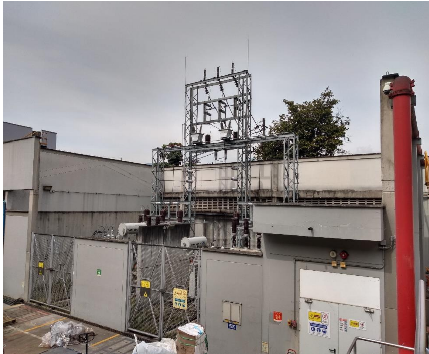
Figura 12. Subestación principal 5 Mva [Fuente propia].
