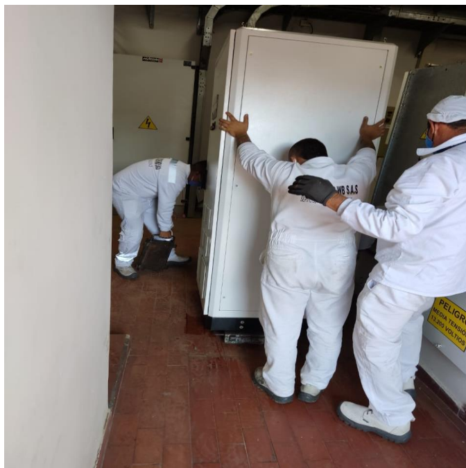
Figura 33. Ingreso del filtro a la subestación de servicios [Fuente propia.]
