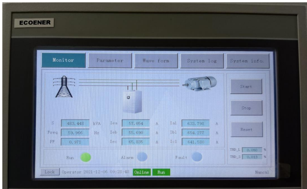
Figura 43. Datos de funcionamiento del filtro activo cuarta semana [Fuente propia].
