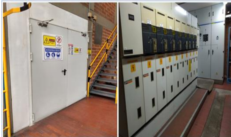
Figura 13. Subestación de servicios P1 izquierda (exterior). Derecha (interior) [Fuente propia].
