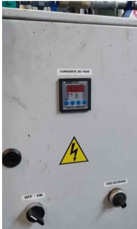
Imagen 37 - Caja de variador
