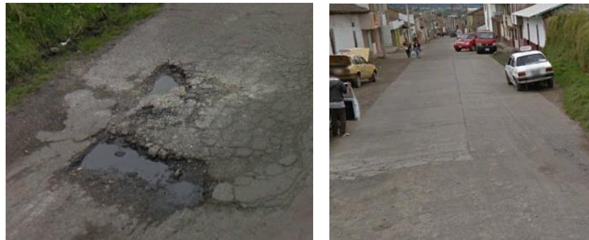
Figura 9. Deterioro vial Fuente: elaboración propia
