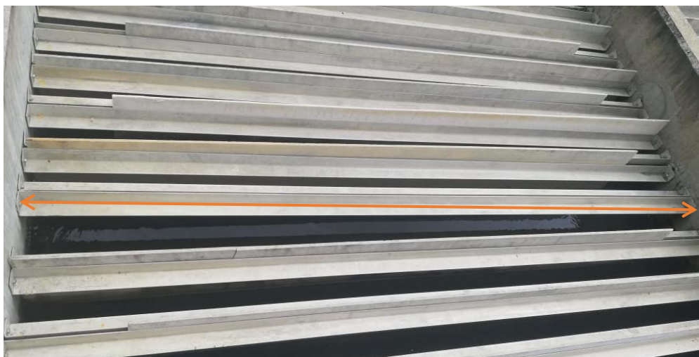
Imagen 1. Placa faltante del floculador. Fuente propia.
