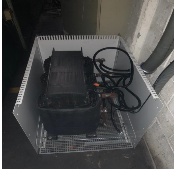
Figura 28: Autotransformador instalado en sitio de operación.
