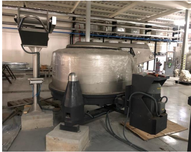
Figura 40: Maquina Centrifuga Instalada.
