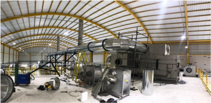
Figura 18: Equipo KMA con ductos y avance parcial en cableado.
