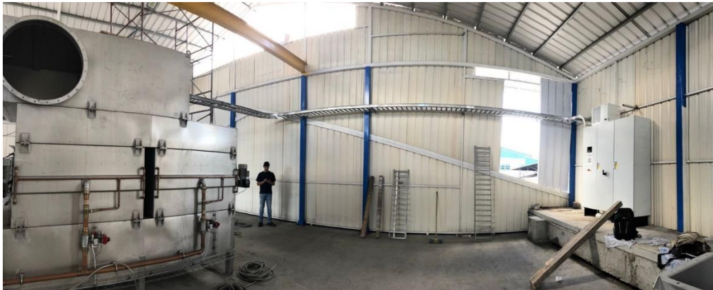
Figura 7: Conexión entre el tablero eléctrico y el filtro de aire KMA.
