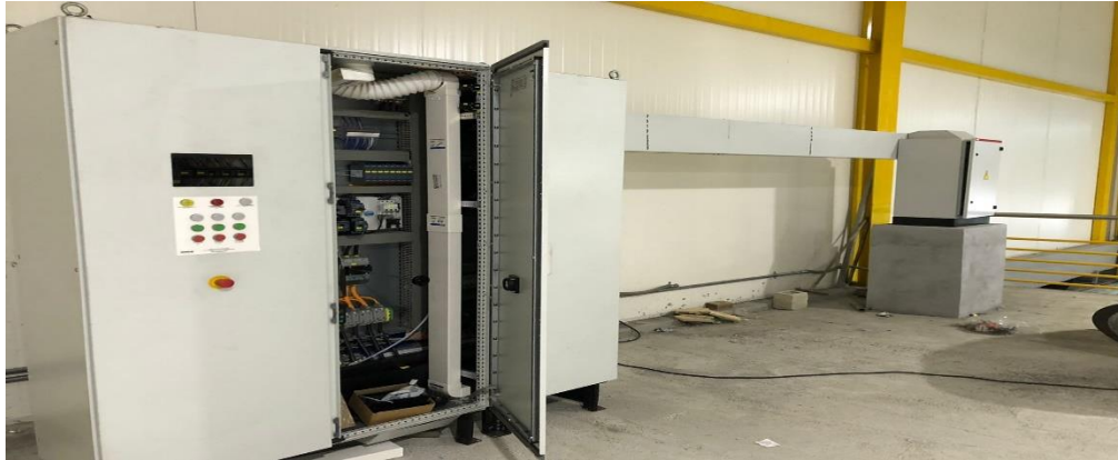
Figura 17: Tablero eléctrico equipo KMA cableado y conectado a blindo barras.
