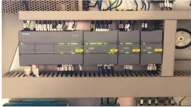
Figura 33: PLC Siemens S71200.
