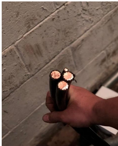
Figura 29: Cable THHN 4/0 utilizado para la acometida de la maquina visto en corte.
