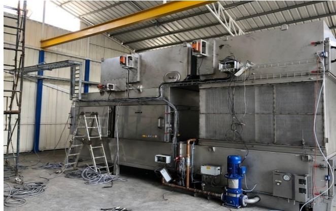
Figura 5: Equipo KMA de filtración de aire en proceso de conexión interna de componentes.
