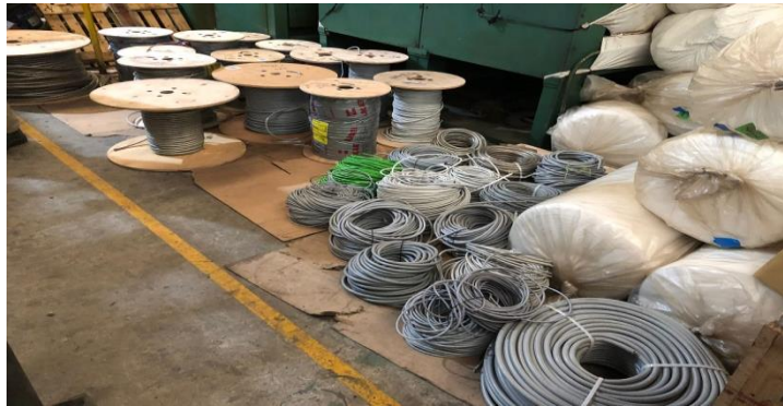
Figura 25: Cableado proporcionado por el fabricante para el ensamble de la máquina.
