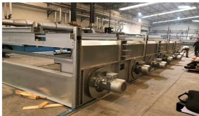
Figura 22: Motores de la Zona de Hornos.
