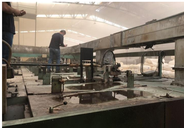
Figura 41: Inspección realizada por personal de FUKUTEX SAS a rama textil incendiada.
