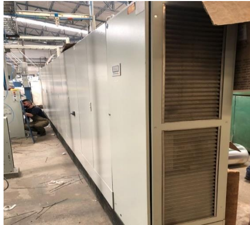
Figura 31: Tablero eléctrico puesto en funcionamiento.
