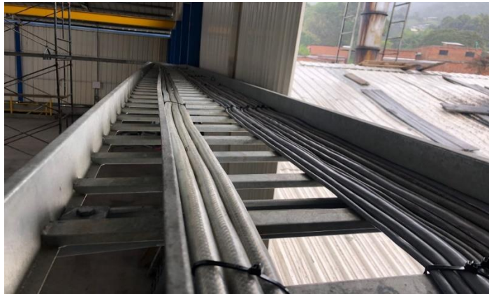
Figura 9: Tendido de cableado de potencia y de control por medio de la bandeja porta cables.
