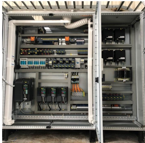
Figura 8: Tablero eléctrico del filtro de aire KMA.
