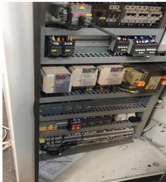
Figura 38: Tablero eléctrico donde se encuentran los variadores de velocidad Yaskawa que fueron intervenidos.
