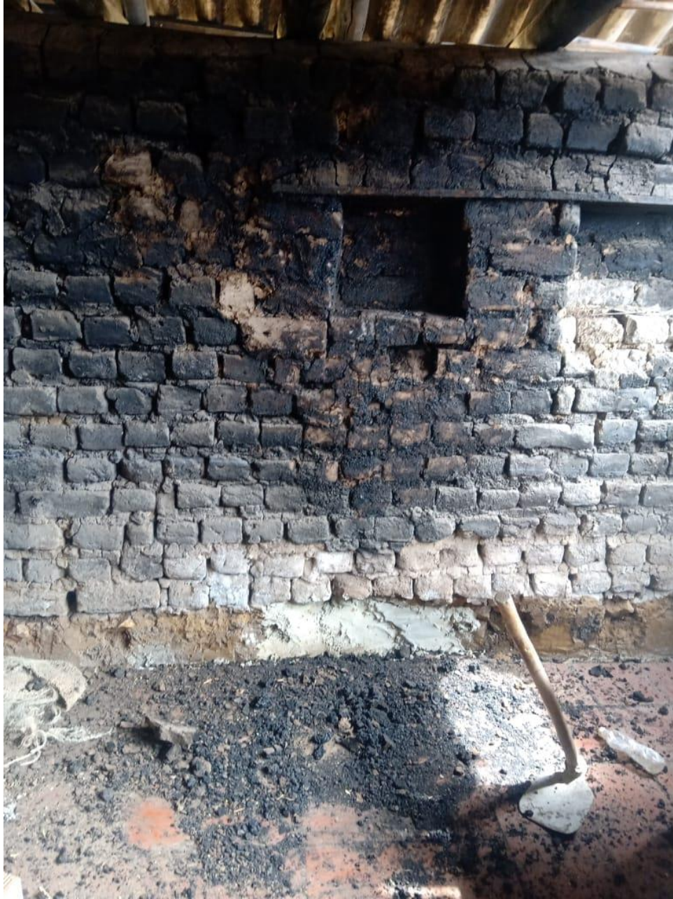
Figura 30 Aspecto de la pared de la cocina antes de la reparación
