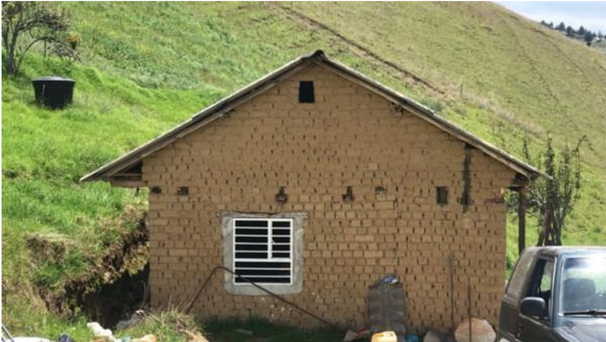
Ventana de la casa resanada con cemento
