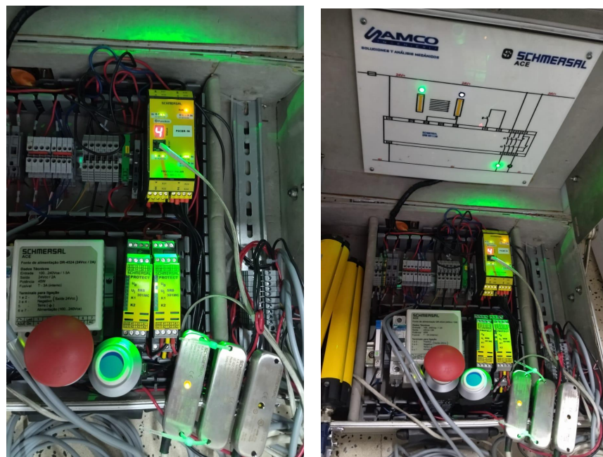
Figura 28. pruebas para PLC de seguridad
