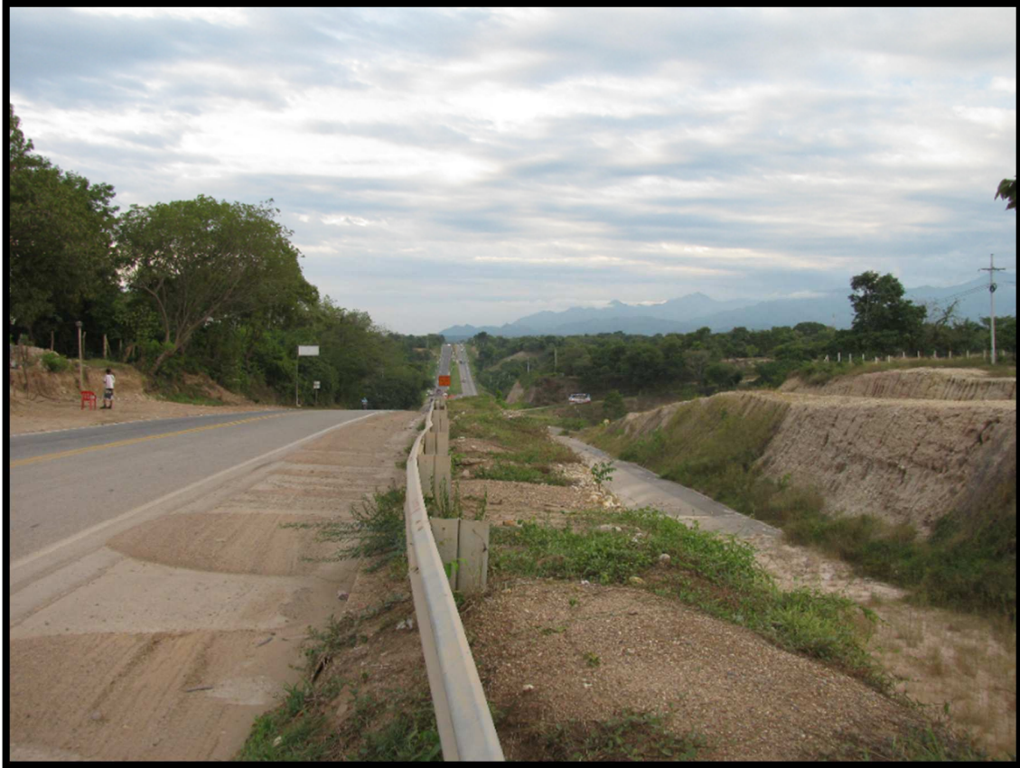
Ilustración 18. Obras de la Ruta del Sol bloqueadas a la altura de Los Columpios, Aguachica. Fuente: la Investigación.
