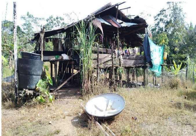
Figura 8. Vivienda en mal estado 1, Chageradó, 2022
