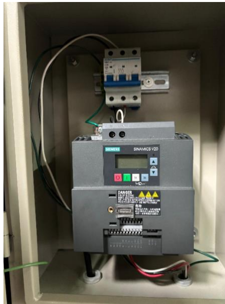
Fig. 35. Gabinete del sistema de velocidad variable.
