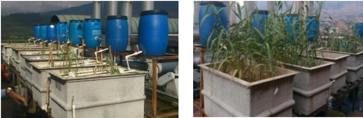
Figura 5. Humedales construidos de flujo subsuperficial pilotos usados en los ensayos de tratamiento del drenaje ácido sintético. Fuente: Propia
