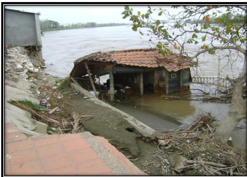
Ilustración 3: Deterioro de viviendas por causa de las inundaciones.
