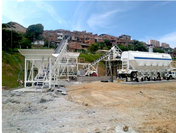
Figura 12 Planta pre mezcladora ALTRON, fuente Cemex.
