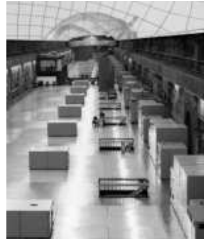
Sala de máquinas de una central hidroeléctrica.
