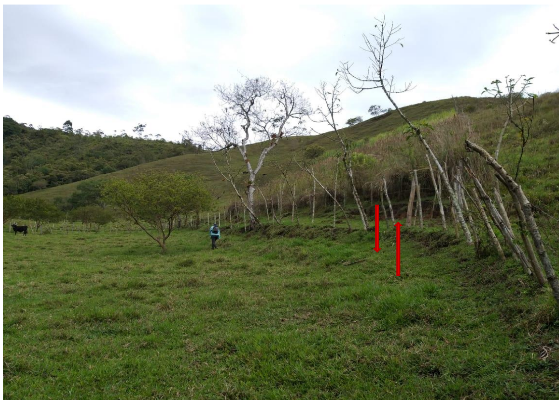
Figura 5. Desplazamiento inminente del material no consolidado de la ladera.
