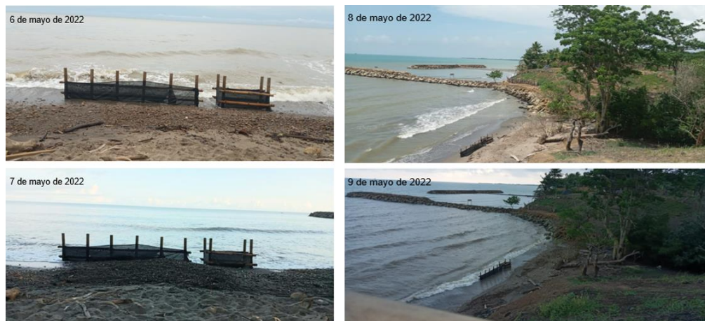
Figura 8. Monitoreo de la estructura y evolución del depósito de sedimentos del 6 al 9 mayo del 2022
