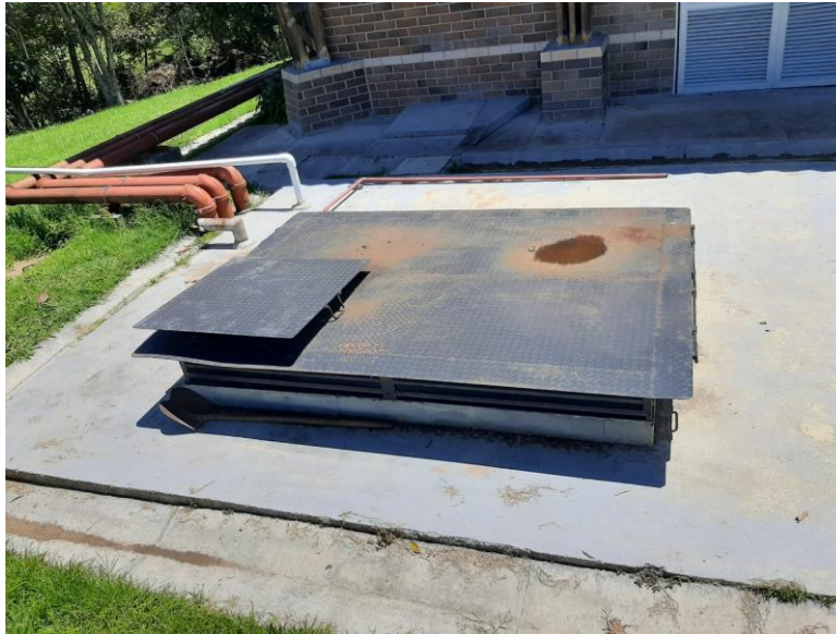
Figura 5. Tanque de almacenamiento
