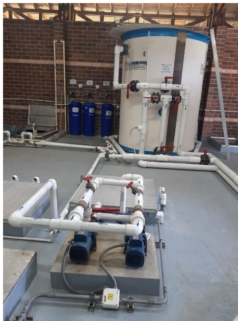
Figura 6. Planta de tratamiento de agua potable
