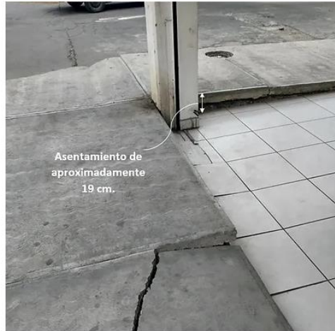
Ilustración 6. Caso ejemplo de asentamiento diferencia en edificación.
