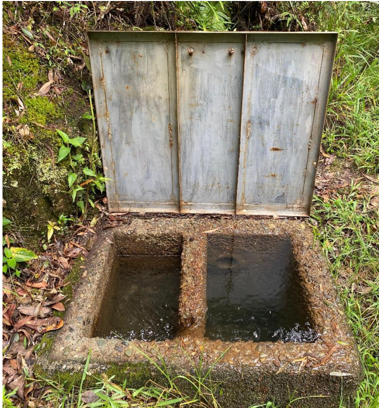
Ilustración 5: Cámara de quietamiento.
