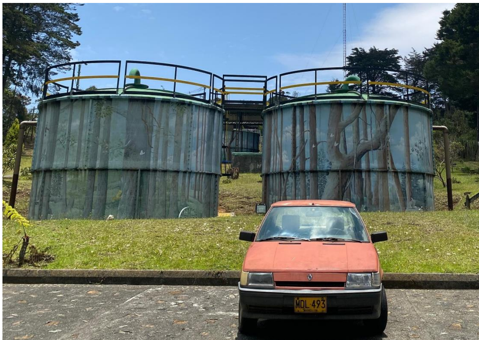
Ilustración 3: Tanques de almacenamiento.
