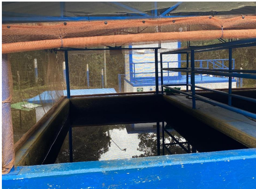
Ilustración 6: Filtros lentos acueducto Mazo.
