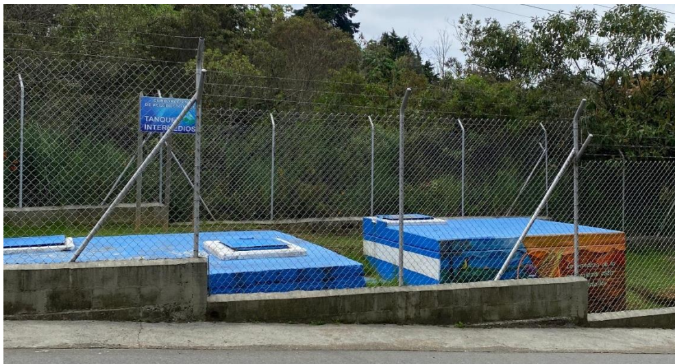
Ilustración 8: Tanques intermedios del acueducto Mazo.
