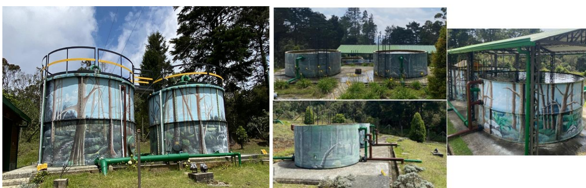
Figura 2. Planta de tratamiento de agua potable del acueducto Santa Elena.
