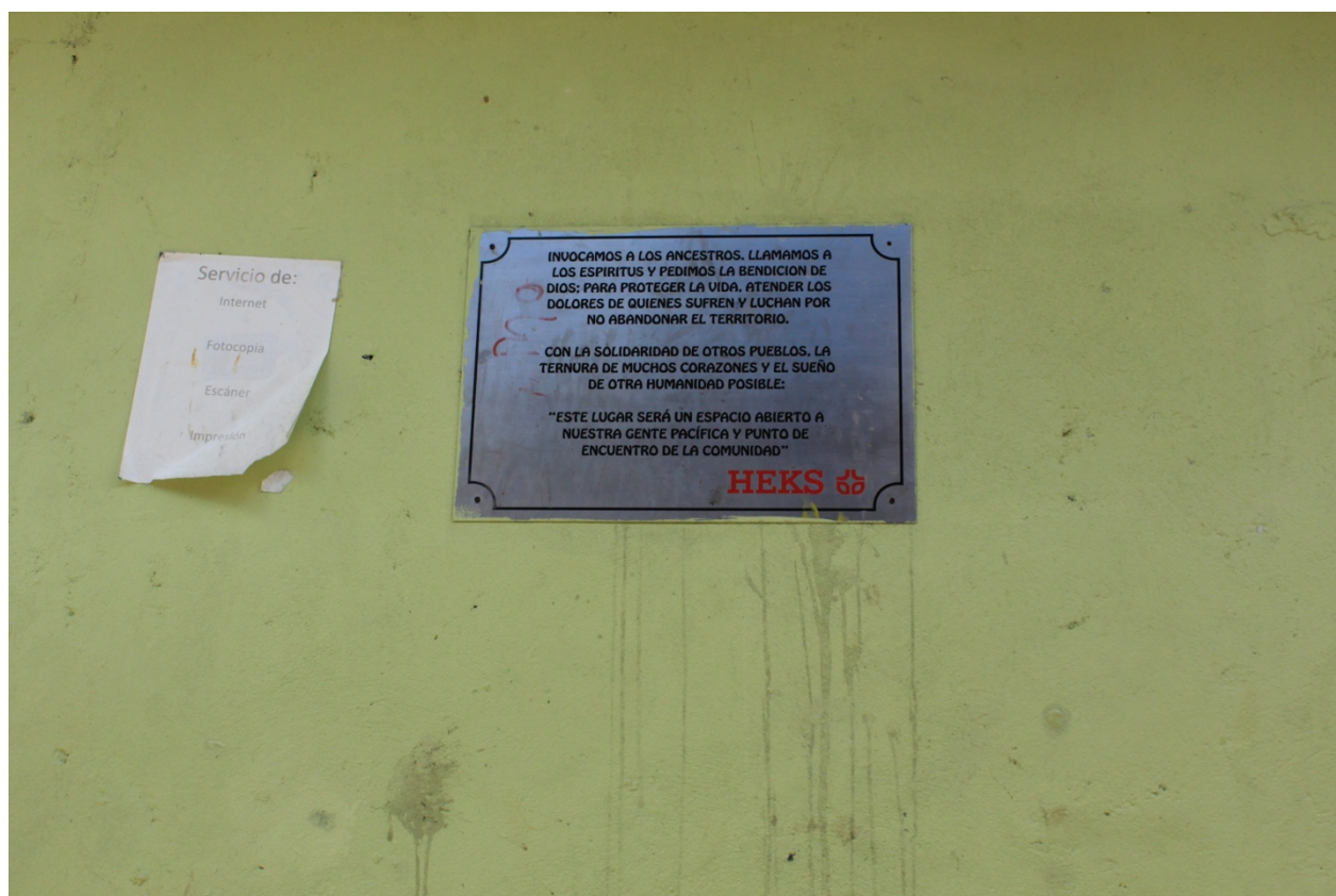
Foto 16. Placa de la sede comunitaria en Villa España. Para el segundo semestre de 2013, la edificación presentaba problemas de infraestructura en uno de sus muros principales.
