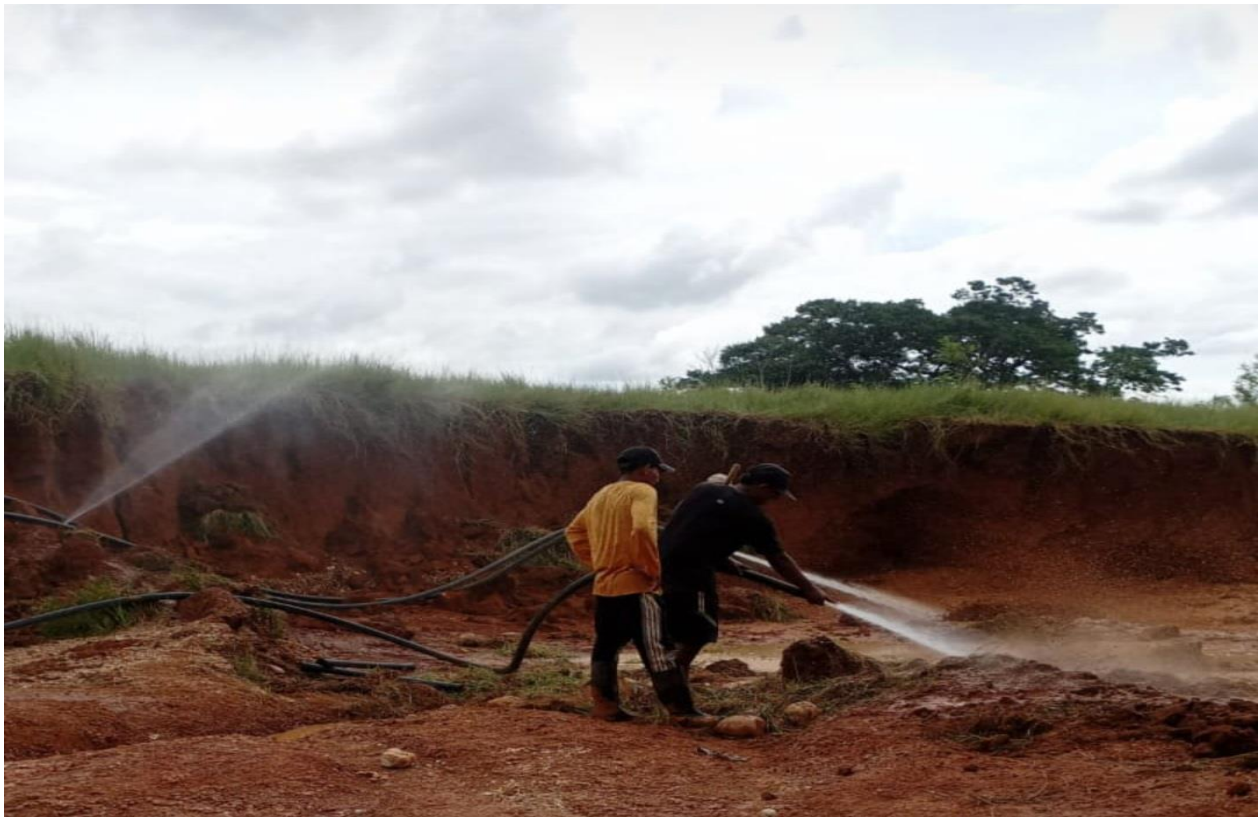
Figura 11: motobombeo Fuente: archivo personal.
