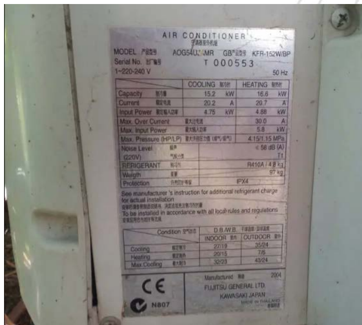
Ilustración 8. Placa de marcación en aire acondicionado.
