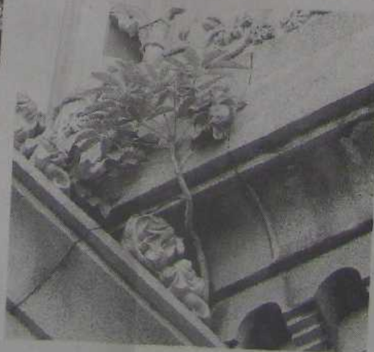
Es tanto el deterioro del edificio, que ya creció este árbol. También nació musgo y mucho moho.
