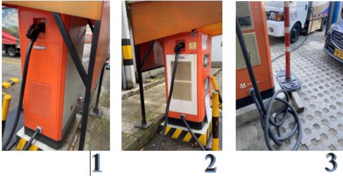
Fig. 9. Equipos con necesidad de rediseño
