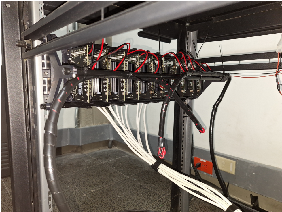
Fig. 16. Sistema de distribución eléctrica montado en el rack.
