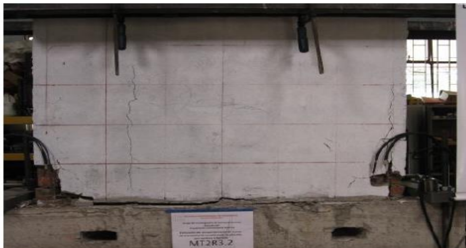
Figura 13: Detalles de la falla en muros reforzados por ambas caras. Deslizamiento del refuerzo longitudinal y falla de los anclajes al cimiento.
