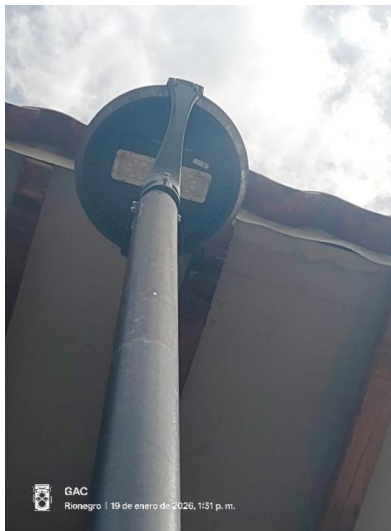
Fig. 4. Luminaria sin rótulo de identificación ni etiqueta de potencia
